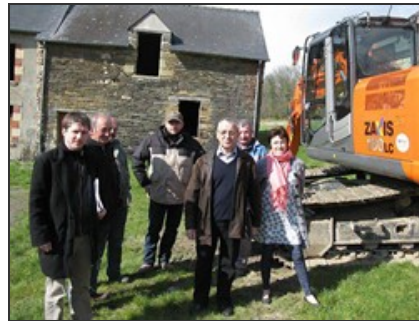
Visite de chantier en présence des élus Robert Perrot et Marie-France Fauchoux, président et vice-présidente du syndicat de Maure et Guer.
